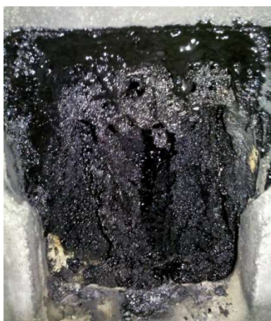
Glanzruß aus Sicht eines Kehrtürchens im Dachboden
